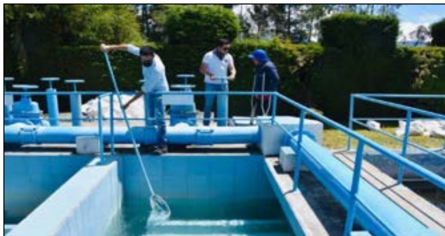
Fotografía 9. Planta de tratamiento de Agua potable el Tejar
